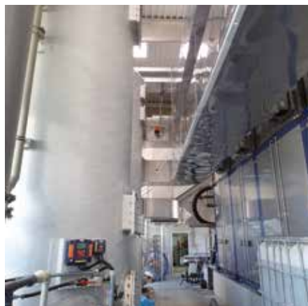
Die neue Bandtrocknungsanlage des ESi (rechts) mit Abgasreinigungsanlage (links)
